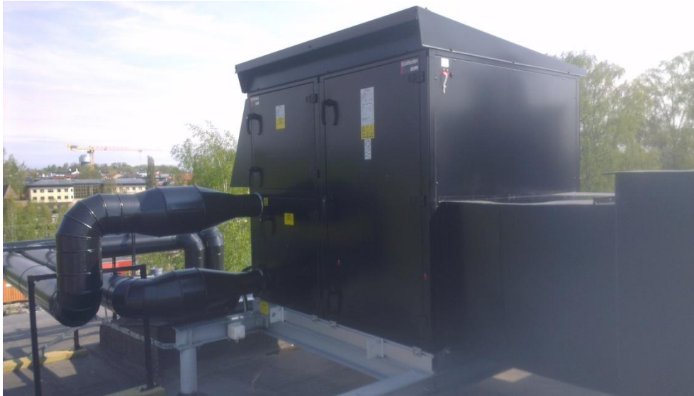
Bild 3: Frånluftsvärmepump Södra järnvägsgatan. Bilden visar frånluftkanalen in till värmepumpen till höger och vattenkretsens fram- och returledning till vänster.
