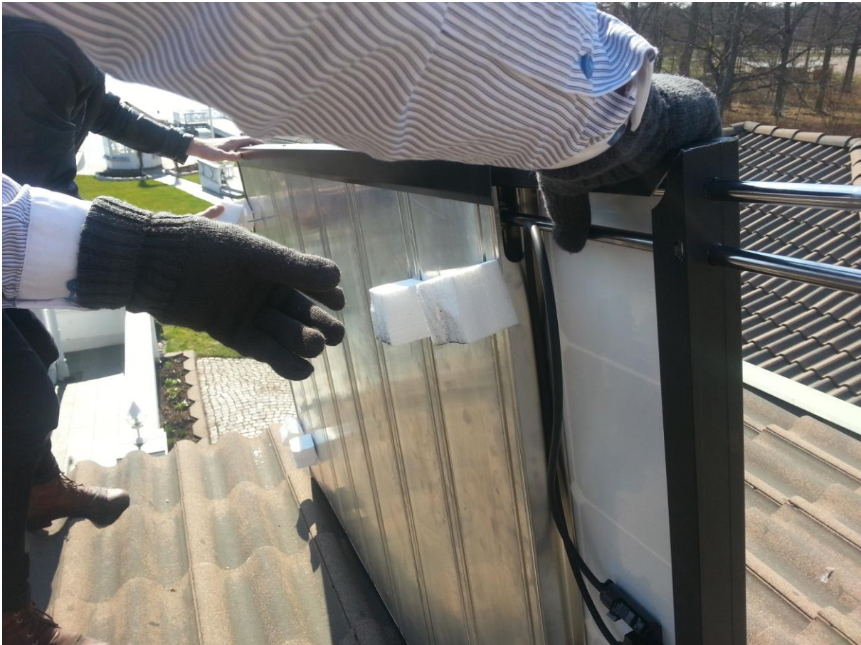
Figur 13 Absorbatorn bakom solcellerna i Öjaby
