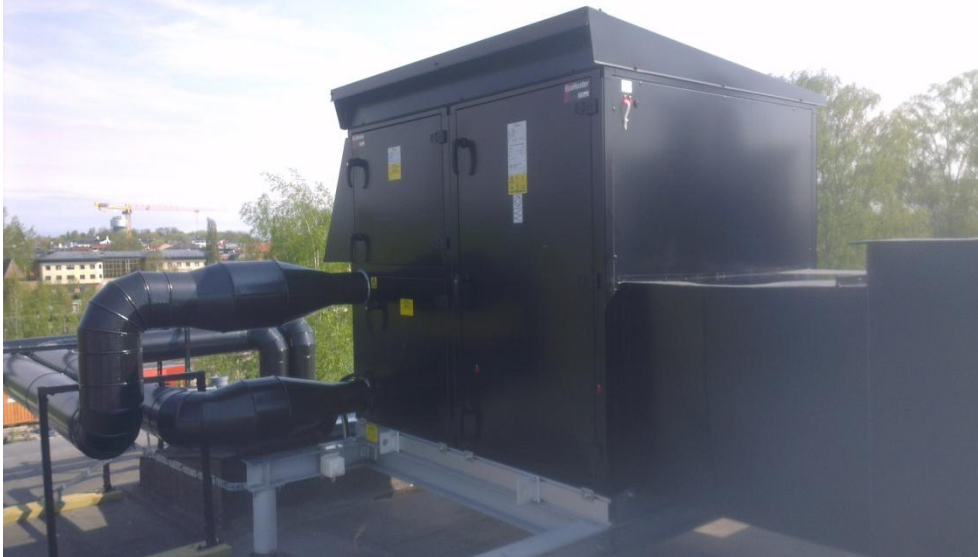
Bild 4: Frånluftsvärmepump Södra järnvägsgatan.
