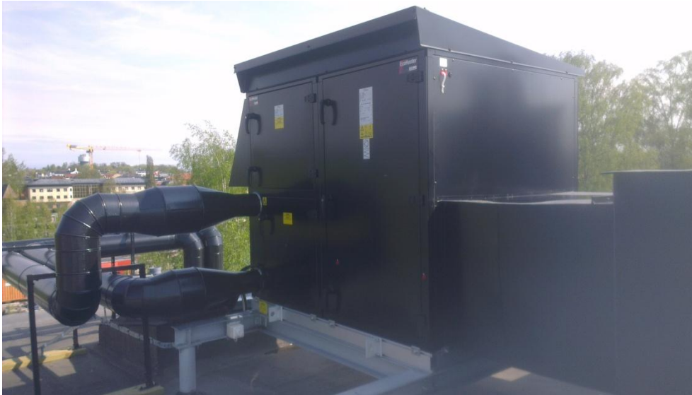
Bild 4: Frånluftsvärmepump Södra järnvägsgatan.
