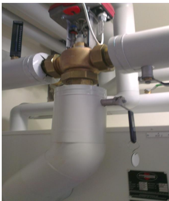
Bild 3: Trevägsventil Toras väg. Trevägsventilen reglerar flödet till de olika vattenkretsarna.
