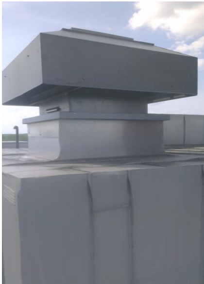
Bild 2: Avluftsdon Västergatan 21. Avluftens temperatur kan enligt uppgift sänkas till cirka -30\text{ }^{\circ}\text{C} , men körs på Västergatan ned till -10\text{ }^{\circ}\text{C} .
