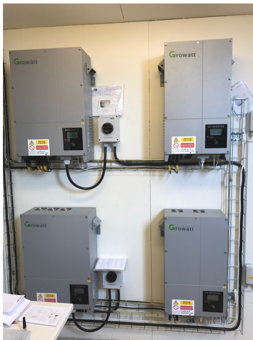
Figur 19. En närbild av växelriktare som installerades i elcentralen i närheten av solcellsanläggningarna.
