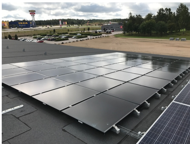
Figur 18. Tunnfilmssolcellsanläggning som monterades på södra taket av skolbyggnaden.
