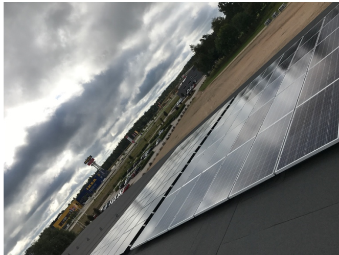
Figur 17. Polykristallina kiselsolcellsanläggning som monterades på södra taket av skolbyggnaden.
